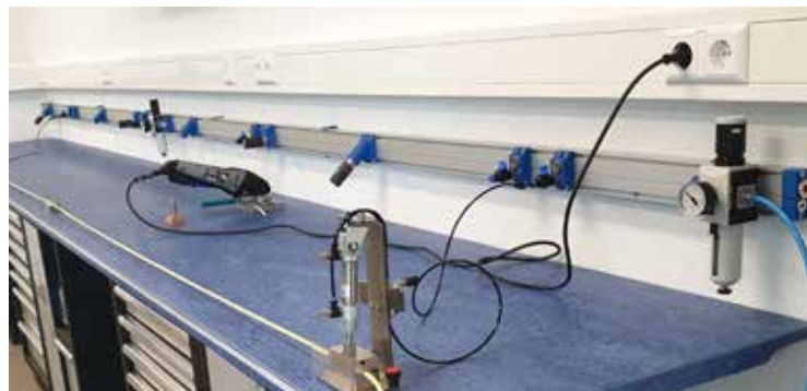
Voorbeeld boven: altijd beschikking over voldoende luchtaansluitingen op de werkplek.
